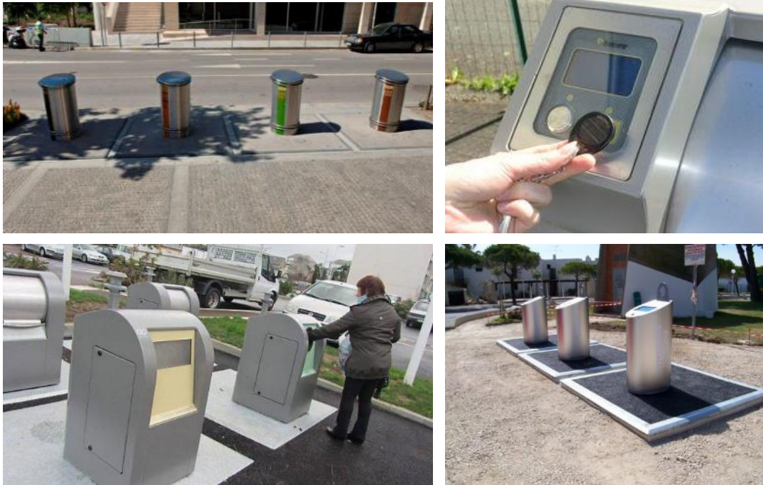
Figure 206 Exemple de système de poubelles collectives enterrées
